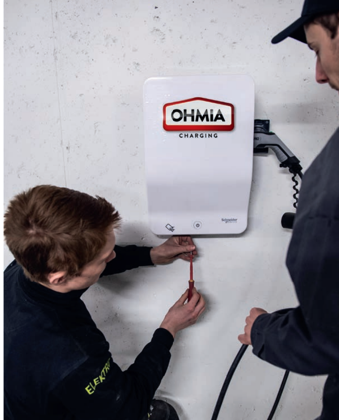
Ohmia Charger monterer anlegget i boligselskapets p-kjeller uten at styret trenger å ta kostnadene. Selskapet følger opp og den som har behov for lader abonnerer på løsningen gjennom Ohmia.
